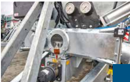
Pumpenkasten mit Schauglas und Fremdkörperabscheider
