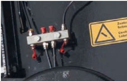
Point de lubrification centralisé
