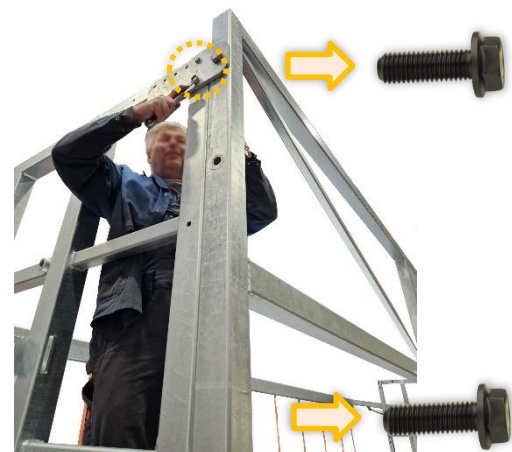
Illustration 38 : desserrage des connexions vissées
